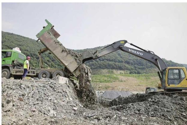
Slika 3. Deponija građevinskog otpada [8]
